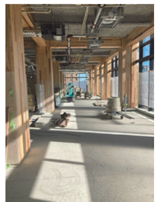
外周部の設備納まり
