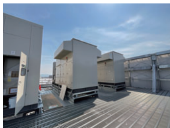
コージェネレーション設備
