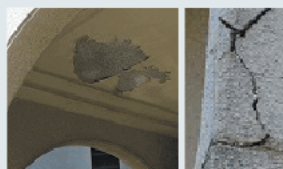
漏水・塗装材剥がれ ひび割れ
