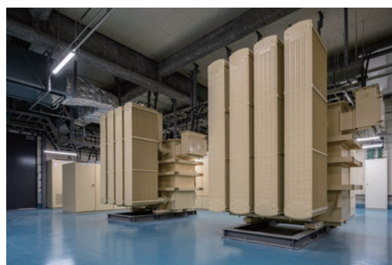
2階に設けた特高電気室
