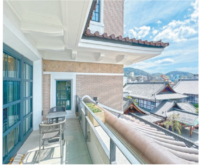
南西4階バルコニーから見る塔屋のピンディングされたタイル
