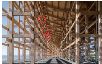
現地照明 取付状況
