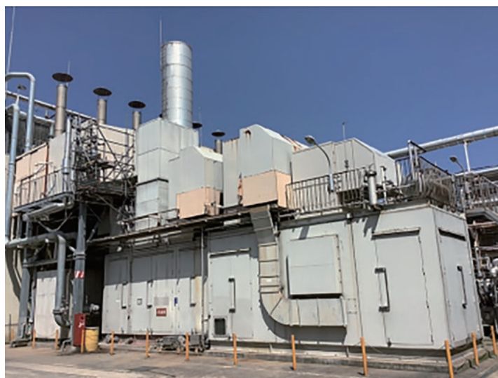
図5 CGS設置状況
