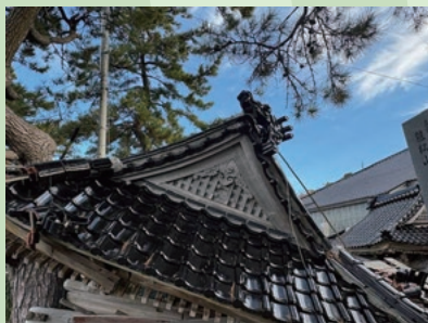
倒壊した黒瓦を葺いた建物 (撮影/藤丸啓一)
