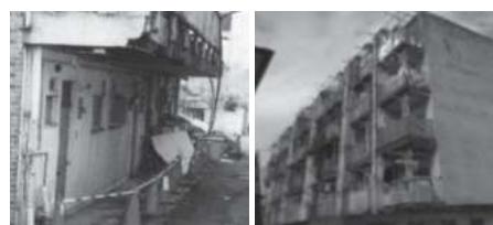
写真1、2 建物の傷みが著しく外壁の剥落等が生じた事例
