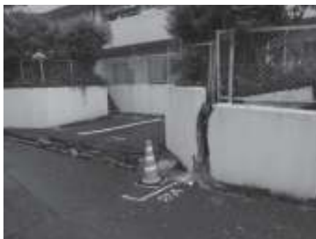
写真5 地震による地盤の変状（'16撮影）
