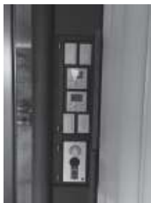
写真3 スイッチ設置部 （扉全開）
