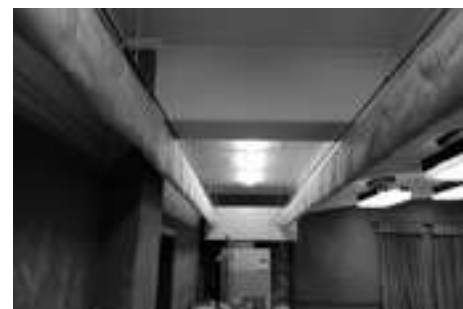
図9 3階の卓球練習場にある空調設備 (2019年12月)
