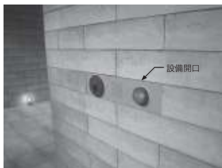
写真2 廊下に面した総合盤の納まり
