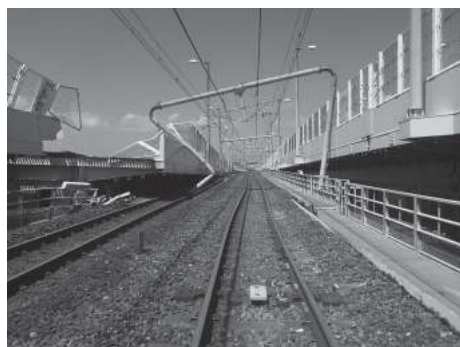
写真1 関西空港線関西国際空港連絡橋の被災箇所
