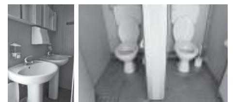
コンテナ製トイレ内部
