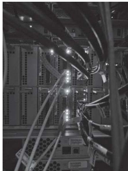
サーバ裏側の光ファイバー配線の様子
