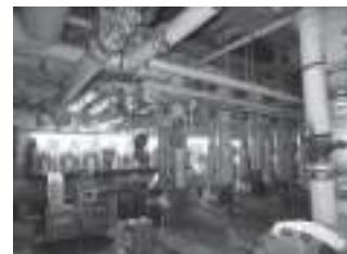
機械室：配管・ダクト状況
