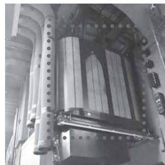
写真3 置換空調吹出口
