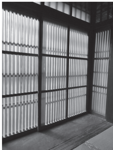
写真1 出格子内観。右端の柱が斜めに写っているのは、レンズの歪みだけでなく、家全体が傾いているため。間口 5.8尺（1,750mm強）。出 1.35尺（400mm強）。面積にして約0.7㎡。内法は、定番の5.7尺（1,700mm強）
