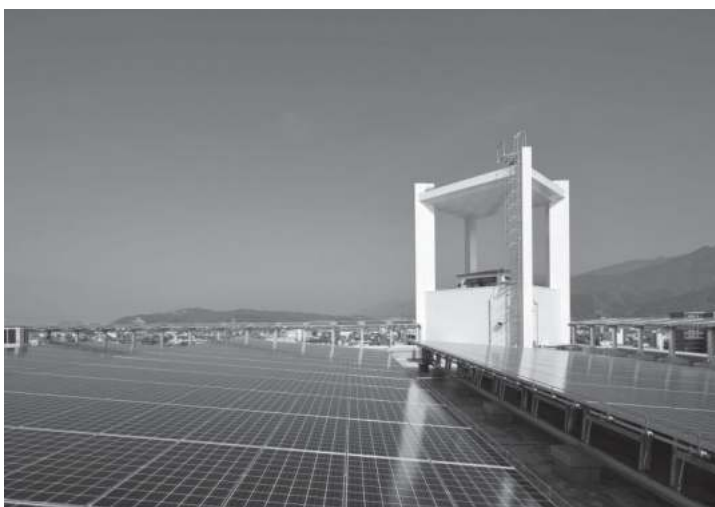
屋上太陽光発電パネルと階段塔頂部の換気口
