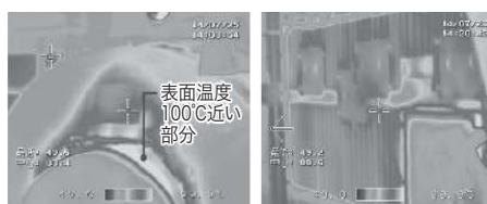
【既存クリーンセンター炉室 サーモカメラ画像】
