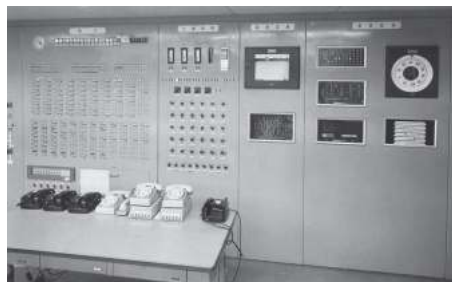
ホテルに導入された空調監視盤
