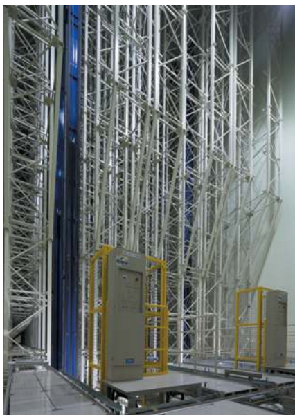
自動ラック倉庫：約2000パレット、-25℃の冷凍保管倉庫
