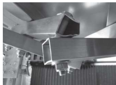
破損例（破損状況の映像を公開中）
