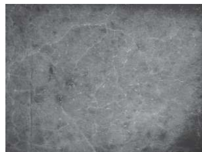
写真1 火害の影響によるひび割れ
