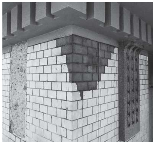
左：削られた装飾跡 中：タイル脱落部の左官補修跡 右：オリジナル装飾
