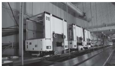
写真1 病院内搬送システム
