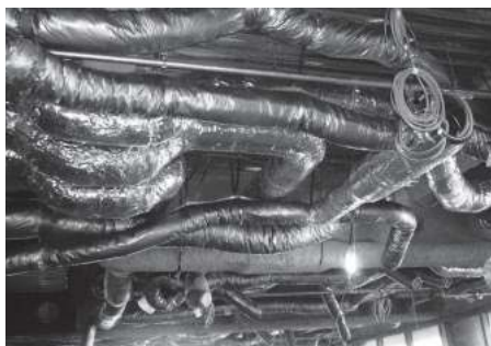
ダクトワーク
