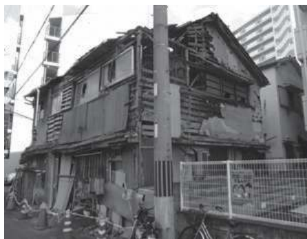
写真2 長屋全体の損傷が激しい
