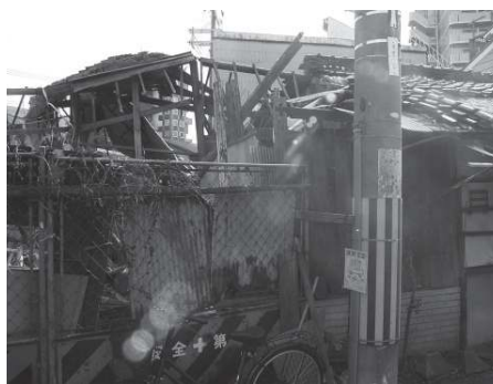
写真1 建物の大半が崩壊している
