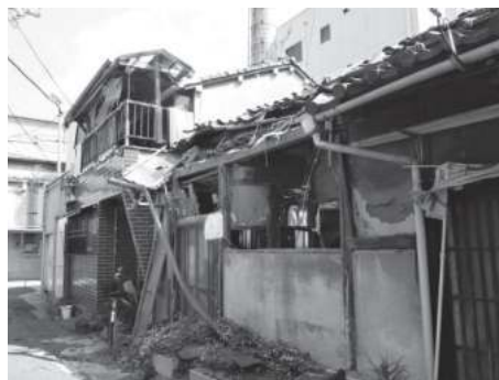
写真4 長屋の内1軒の損傷が激しい
