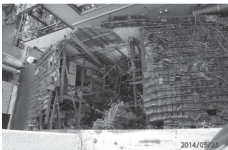
写真6、7 崩落が激しく、倒壊の恐れがあった
