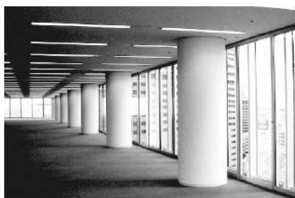
▲ 丸柱の耐火被覆
