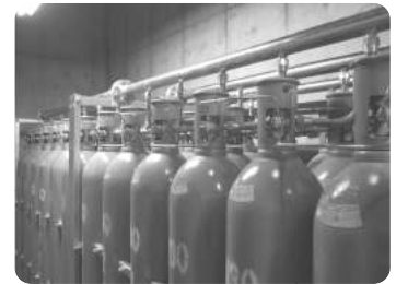
防災事業（窒素消火設備）
