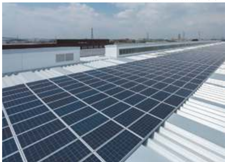
部品工場屋根 太陽光発電パネル（＊）
