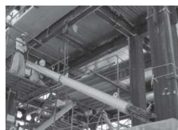
図3 ブレースダンパーの取り付け状況
