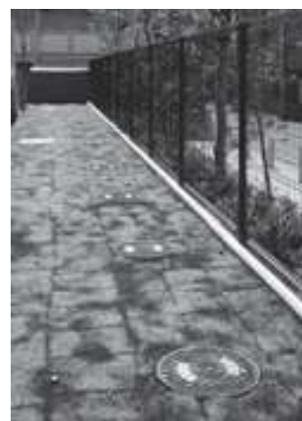
マンホールトイレ
