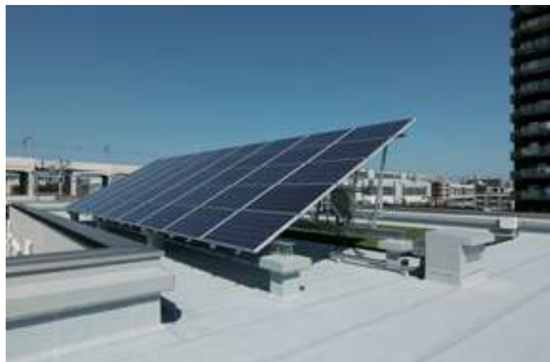
屋上 太陽光パネル、屋上緑化
