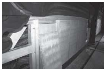
写真4 土壁パネル: 開口部上部の小壁に設けた制震材
