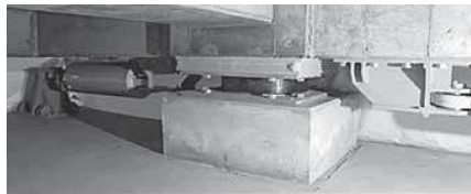
写真6 免震ゴムとオイルダンパー
