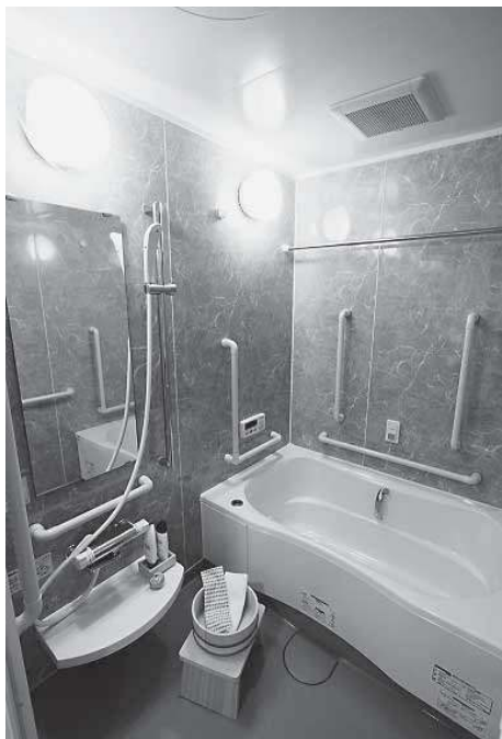
Cアミーユに設置している個室浴室
