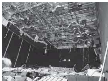
写真1 映画館の天井落下
