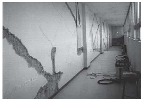
建築2次部材（壁）の損傷状況
