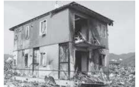
鹿折地域に残存する住宅の焼損状況
