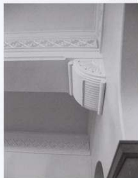
⑲ 3階2号室のハンチ
