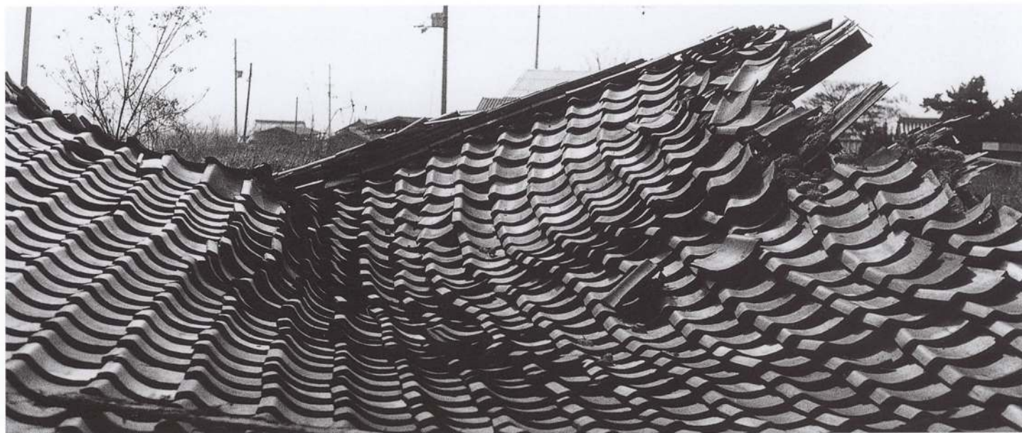
淡路島・三原 必至に生き残る屋根瓦の生命力。1990年撮影
