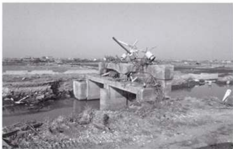
津波により破壊した水門 (仙台市)
