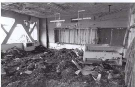
1階の教室の天井に残る痕跡 (仙台市)
