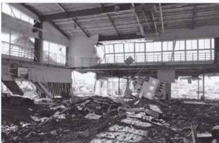
1階の壁がほとんどなくなった体育館 (仙台市)
