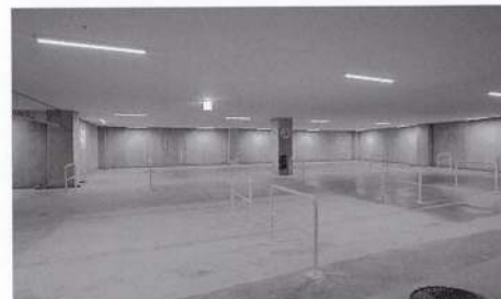
写真2 イトーヨーカドー武蔵小岩井店 駐車場のLED照明
