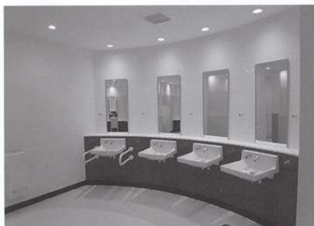
写真5 アリオ橋本 トイレのLED照明
