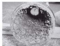
写真2 雑排水立て管の現状
