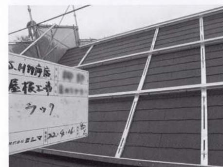
架台設置型モジュールのフレーム
