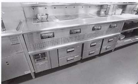
IH調理器の下に「台下冷蔵庫」を組み込み、 効率的な調理作業環境を実現
