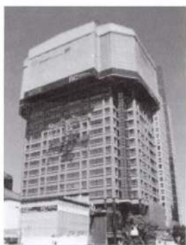
写真6 スマートシステム (清水建設)
