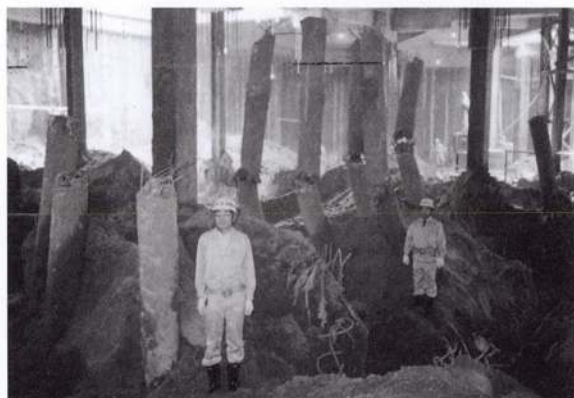
写真2 1964年新潟地震の20年後に掘り出された破損した杭
