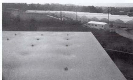
写真2 2007年台風15号で防水層が吸い上げられた状況
