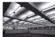
照明器具 実装写真
