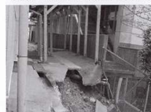
写真11 玄界小学校の被害
