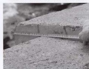
写真14 玄界島における防波堤の被害
