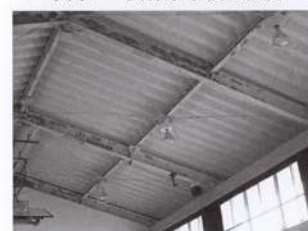
写真13 玄界小学校の体育館におけるブレースの座屈
