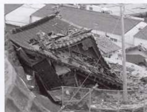
写真10 玄界島における家屋の被害
