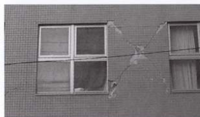
写真1 柱のせん断破壊
