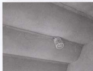
写真8 体育館の屋根材の被害
