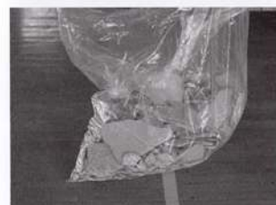
写真9 落下した体育館の屋根材
