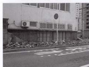
写真5 ブロック塀の被害
