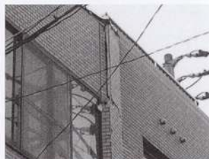
写真4 外装材（タイル）の被害
