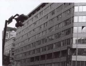
写真6 福ビルの窓ガラスの被害
