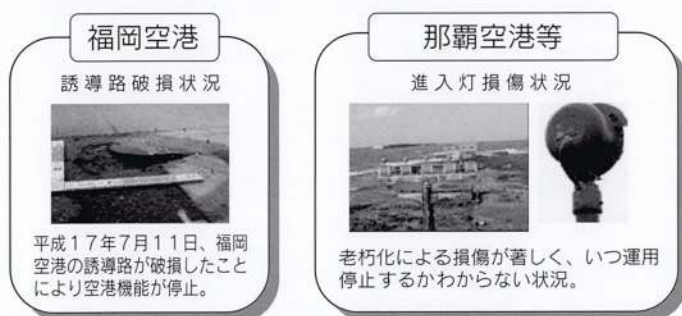
図11 空港施設の破損・損傷事例
