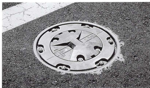
写真2 舗装内に埋め られた灯器
