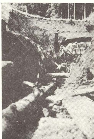
図—13 両総用水34号隧道 Well point 設置直前の 導坑崩壊状況 1953—7
