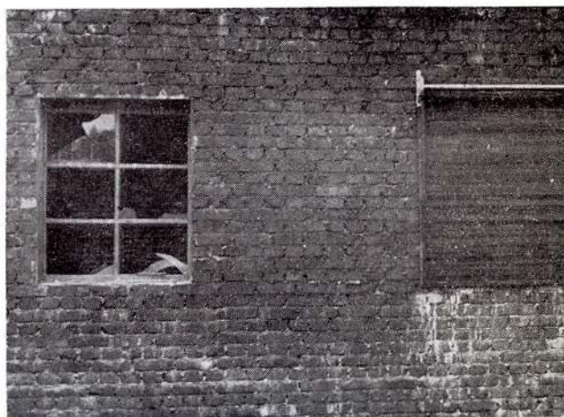
35. 南側窓の被害
