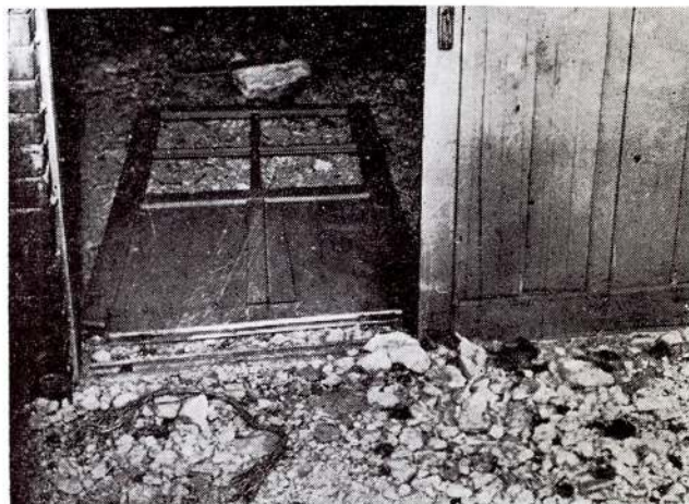
34. 西出入口硝子戸の被害
