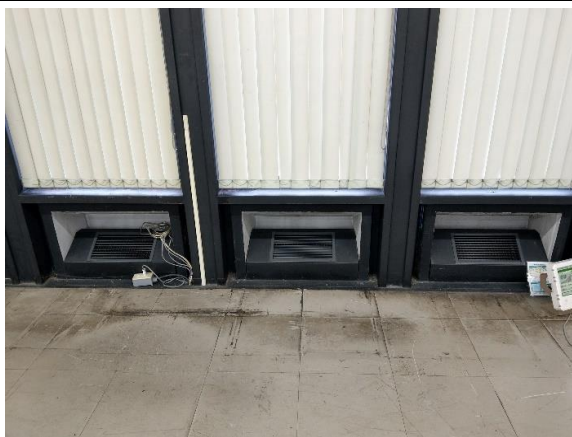
外壁回りの空調吹出口 床下エアチャンバーからのエア供給
